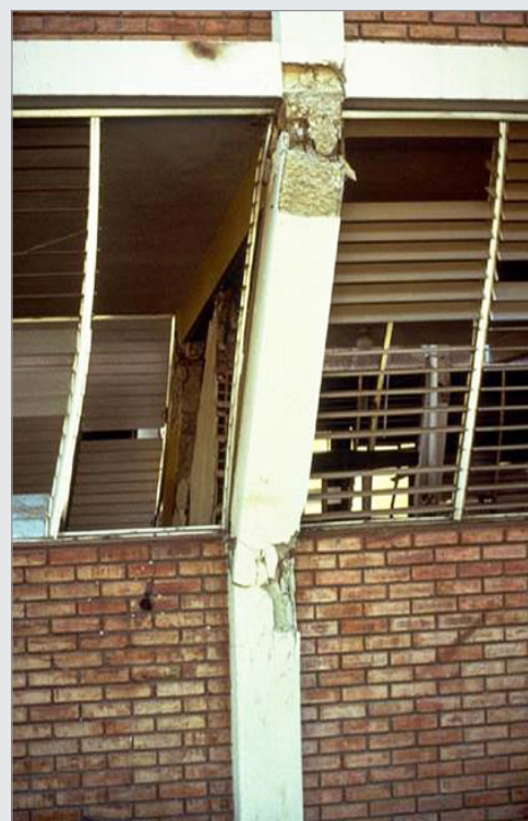
شکل ۹: شکست ترد برشی در ستون بتنی
