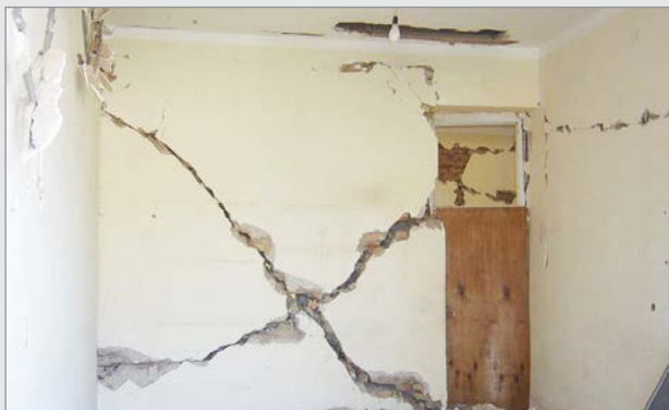
شکل ۱۳: شکست انفجاری دیوار بنایی
