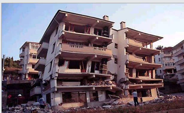
شکل ۱۱: تخریب در اثر حرکت پیچشی ساختمان
