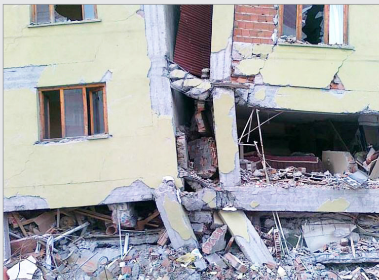
شکل ۸: تخریب ساختمان در اثر طبقه نرم زیرین
