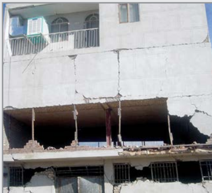
شکل ۳: انهدام خارج از صفحه دیوارهای بنایی
